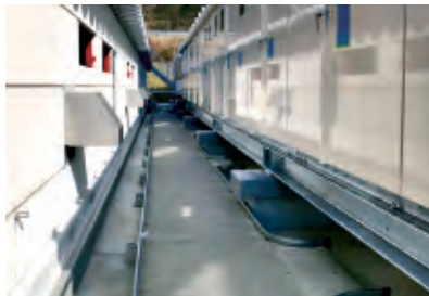
キュービクル架台
