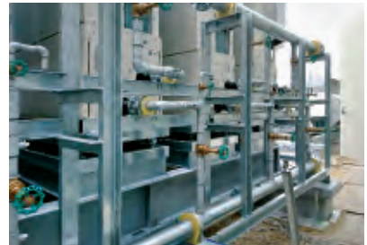
ユニット架台
